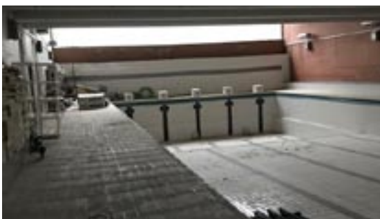
In der alten Schwimmhalle, die heute dem Zerfall preisgegeben ist, waren Trainingsräume für die Ringer, Judoka und Boxer vorgesehen.
